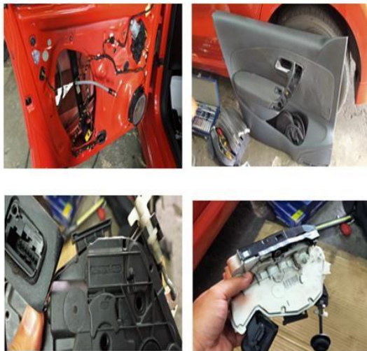
GAMBARAJAH: KERJA-KERJA BAIK PULIH POWER WINDOW DAN MENUKAR INNER LOG YANG BARU
